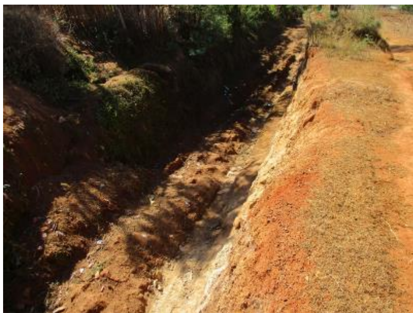
Photo 68 : Route d'accès vers le site d'enfouissement (Ambohibary) impraticable en période de pluies
