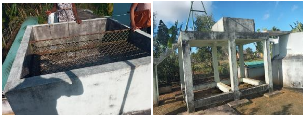
Photo 50: Bassin de réception muni d'un dégrilleur dans la STBV de Mahatsaranarana
