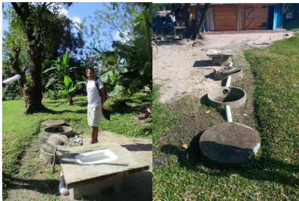
Photo 57: Type de WC DIOTONTOLO équipé de fosse septique
