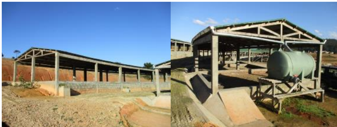
Photo 15 : Lit de séchage non planté
