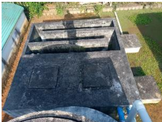
Photo 51: Filtre anaérobie et bassin de maturation dans la STBV de Mahatsaranarana
