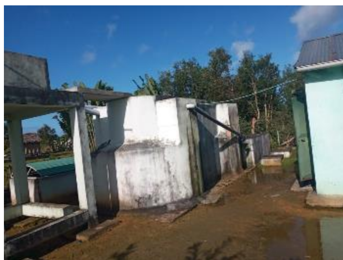
Photo 49: Biodigesteurs dans la STBV de Mahatsaranarana
