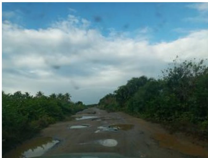
Photo 41: Etat de la Route Nationale 5a
