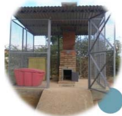
Incinérateur simple chambre
